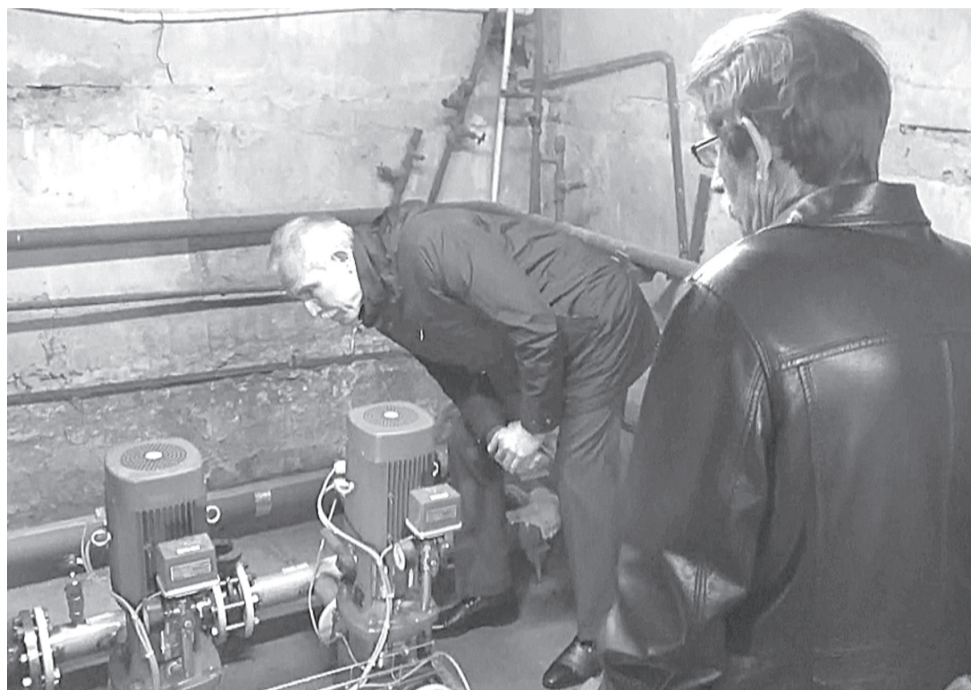
перед совещанием Сергей Морозов осмотрел выполненный капитальный ремонт многоквартирного дома № 11 на ул. Пушкинской в Ульяновске.
